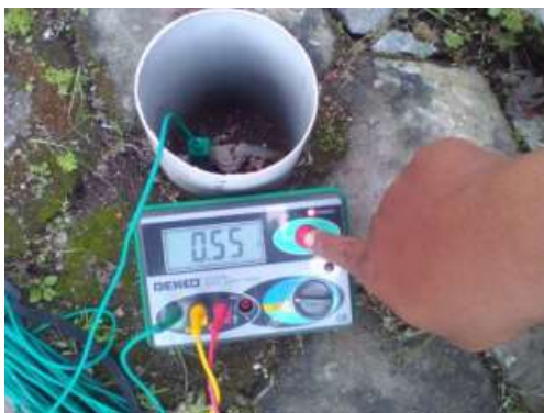
Gambar 8. Hasil Pengukuran Tahanan Pentanahan Shelter
