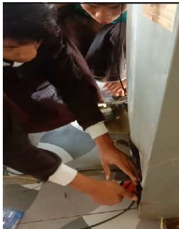
(e) Pematangan pipa tembaga
