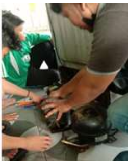
(g) Penggantian Kompresor
